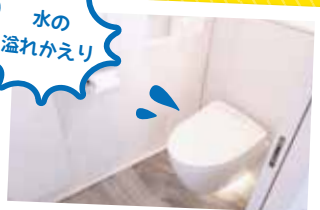
トイレ詰まり
